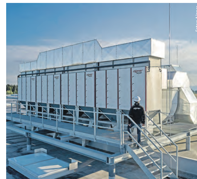
Feinstaubfilteranlage für eine Schweißhalle
